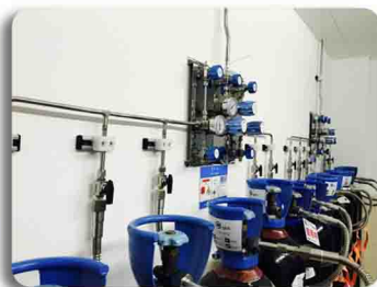
华南理工大学（汇流排系统）
