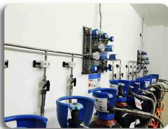
华南理工大学(汇流排系统)
