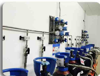
华南理工大学(汇流排系统)
